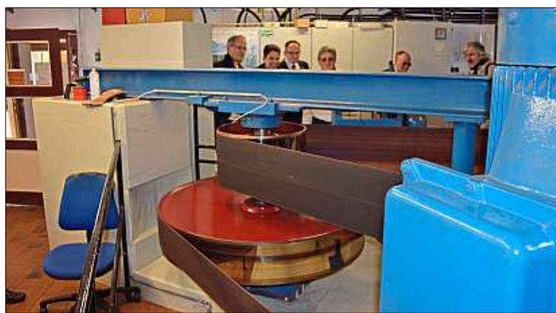
Blick ins Maschinenhaus am Elektrizitätswerk von Mühlen- und Kraftwerksbetreiber Hans Gfaller.
